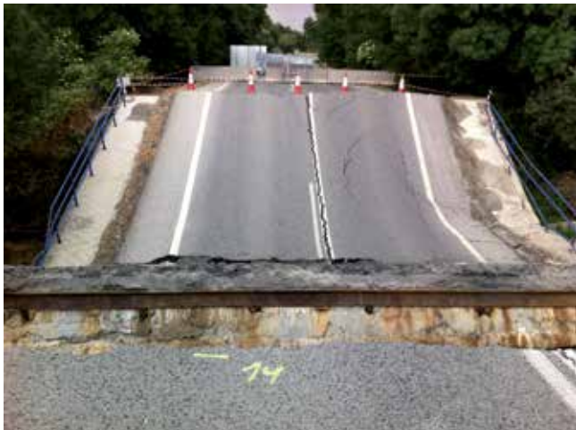
Fig. 1. El puente colapsado, el 5 de junio de 2015
