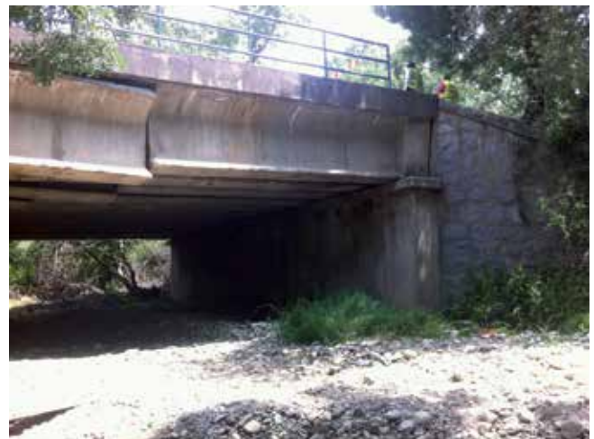
Fig. 11. El puente colapsado, minutos antes de desplomarse
