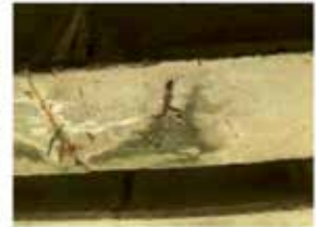
Desconchones/lajas (con armadura pasiva implicada), librería 6, en Elemento Vigas del Componente V1 (Deterioro 9)
