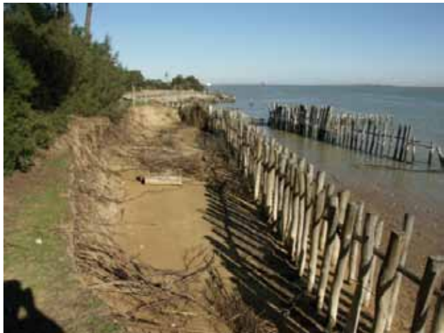
Fig. 5. Erosión en las márgenes del Guadalquivir
