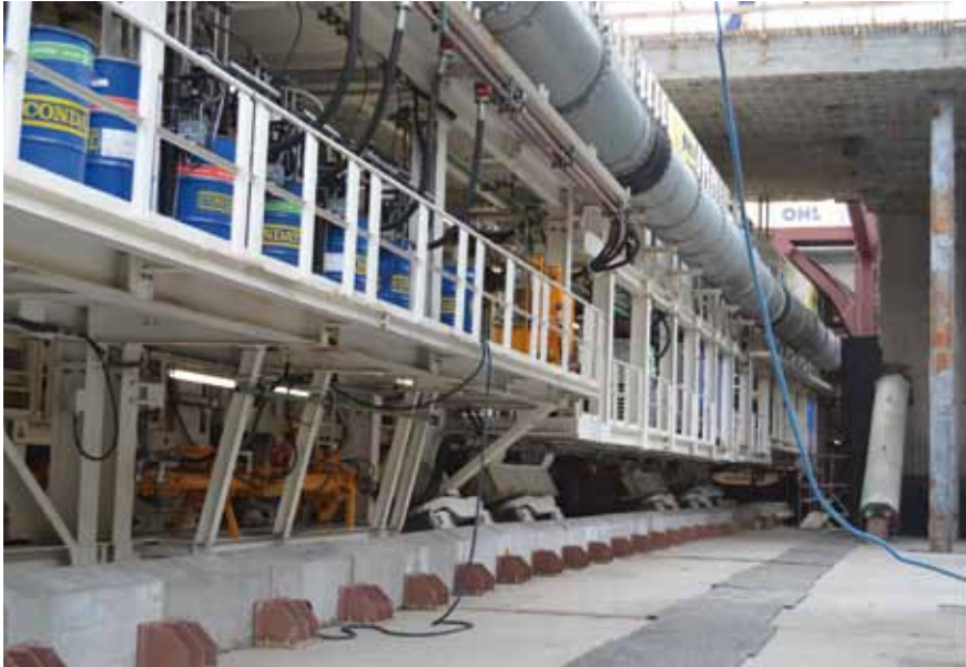
Túnel carretero de Gdansk, realizado por OHL, el de mayor diámetro de toda Polonia
