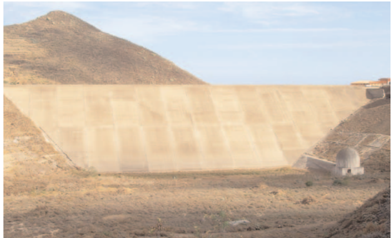
Fig. 6. Presa de los Campitos en Tenerife, nunca ha embalsado agua (Santamarta J.C.)/ The Campitos Dam in Tenerife has never stored water (Santamarta J.C.).
