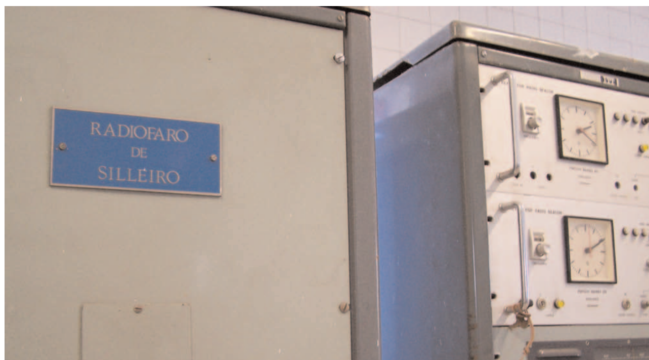
Fig. 13. Sistema de control del radiofaro de Silleiro.
