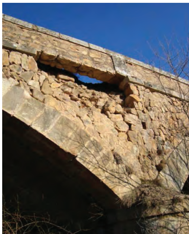
Fig.11. Deterioro en el tímpano del puente de Lavalé (Fotografía: Juan Donaire Merino).
