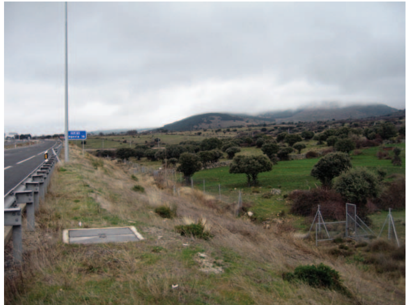
Fig. 3. Puerta basculante en el vallado perimetral en Portillo, autopista AP-61. Fuente: Castellana de Autopistas S.A./ Swing gate on outer fencing at Portillo, on the AP-61 motorway. Source: Castellana de Autopistas S.A.
