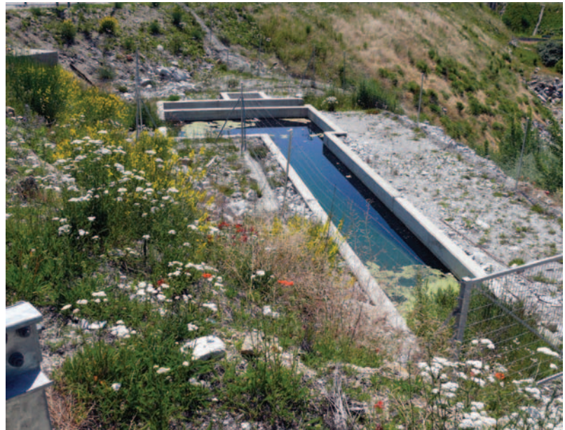
Fig. 2. Balsa de contención, margen derecha, en la autopista AP-6. Fuente: Iberpistas S.A./ Waste holding tank, right-hand side of AP-6 motorway. Source: Iberpistas S.A.
