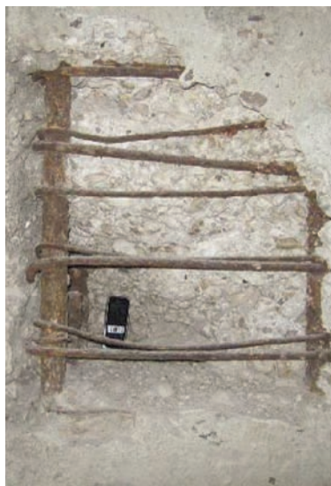
Detalle de nido de grava picado en estribo.
