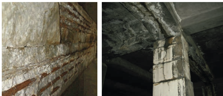
Detalle de tablero. Vigas centrales con armadura corroída. A la derecha, detalle de encuentro de tablero con pilas centrales. Problemas de filtración bajo la junta de dilatación.
