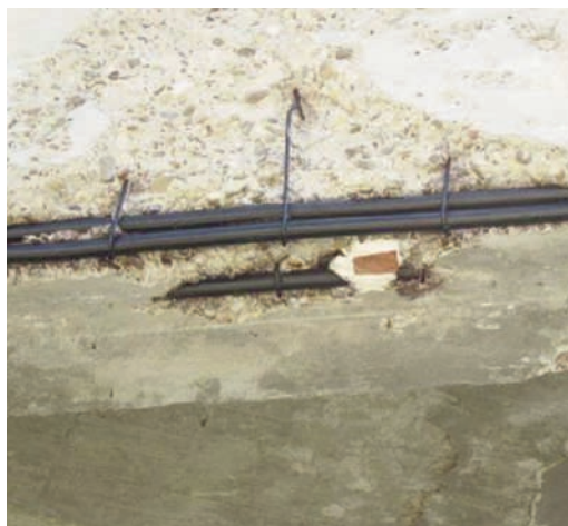
Detalle de armadura pasivada después de chorreado.
