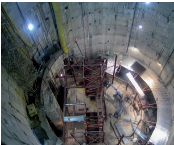
Estación en pozo de 32 m de diámetro en la Línea 9 del Metro de Barcelona. A la derecha, Túnel a cielo abierto para el acceso de trenes de cercanías a la Terminal T-4 (Madrid).
