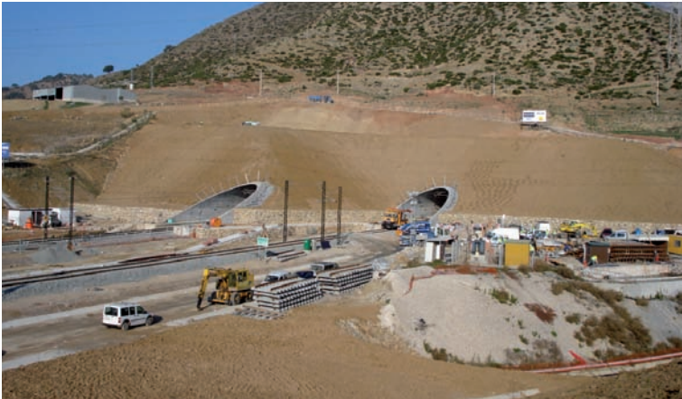
Túneles de Abdañajís-LAV Córdoba-Málaga. A la derecha, Ampliación de la Línea 3 del Metro de Barcelona.
