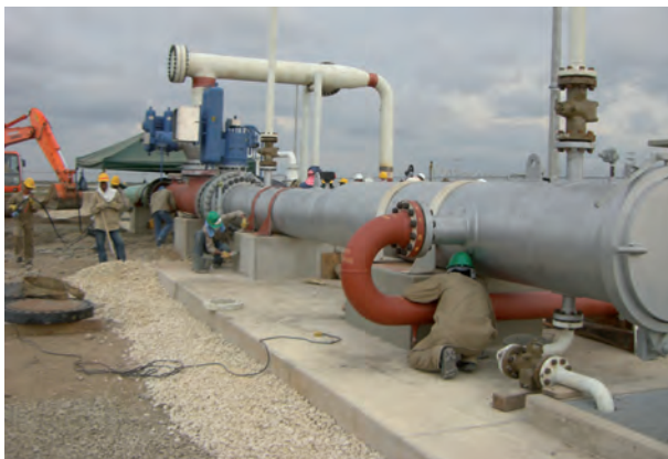
Gasoducto/ Gas pipeline.
