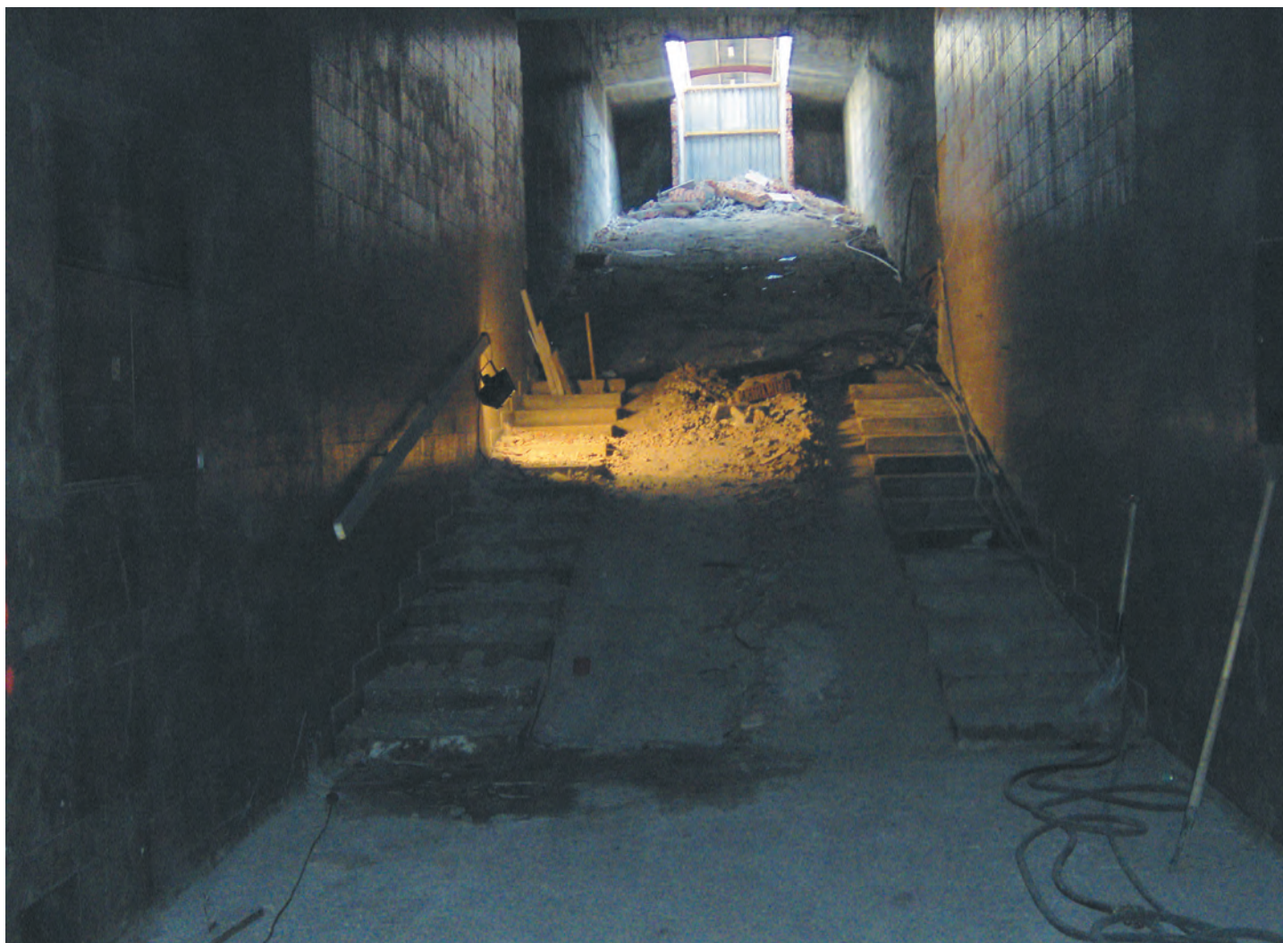
Fig. 8. Vista del interior de las estructuras atravesadas / View of underground existing structure.
