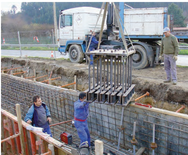
Cimentación micropilotada de la pila central y contratirante. Pieza de anclaje de la pila en cemento.
