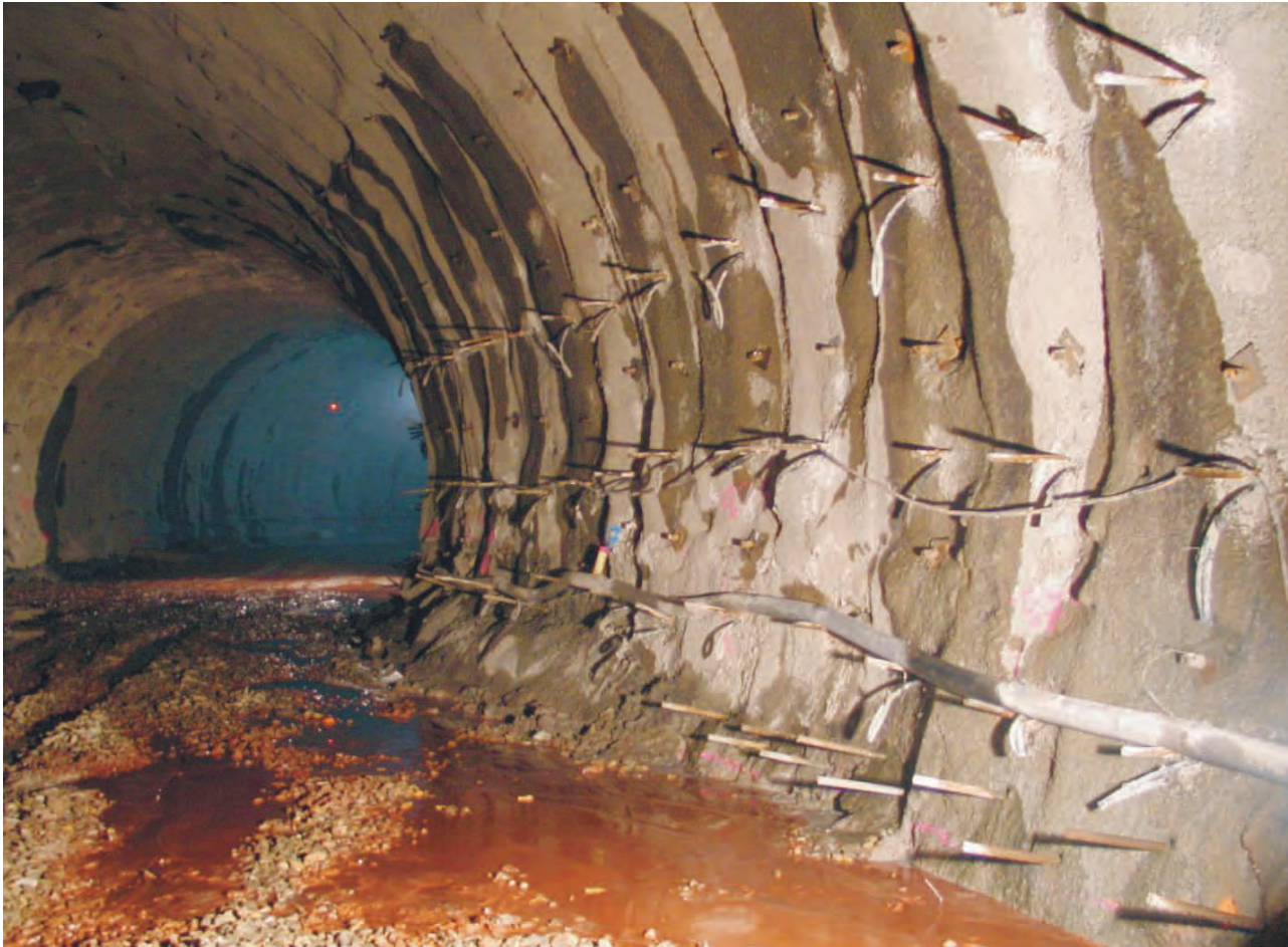
Fig. 15. Refuerzo mediante bulones autoperforantes de 9 m en la base de los hastiales de la galería/Reinforcement with 9 metre self-drilling rock bolts at the base of the tunnel walls..
