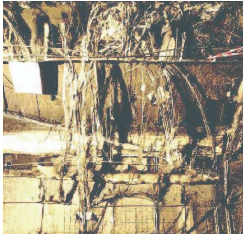
Fig. 4. Incendio en el Eurotúnel/Fire in the Eurotunnel.
