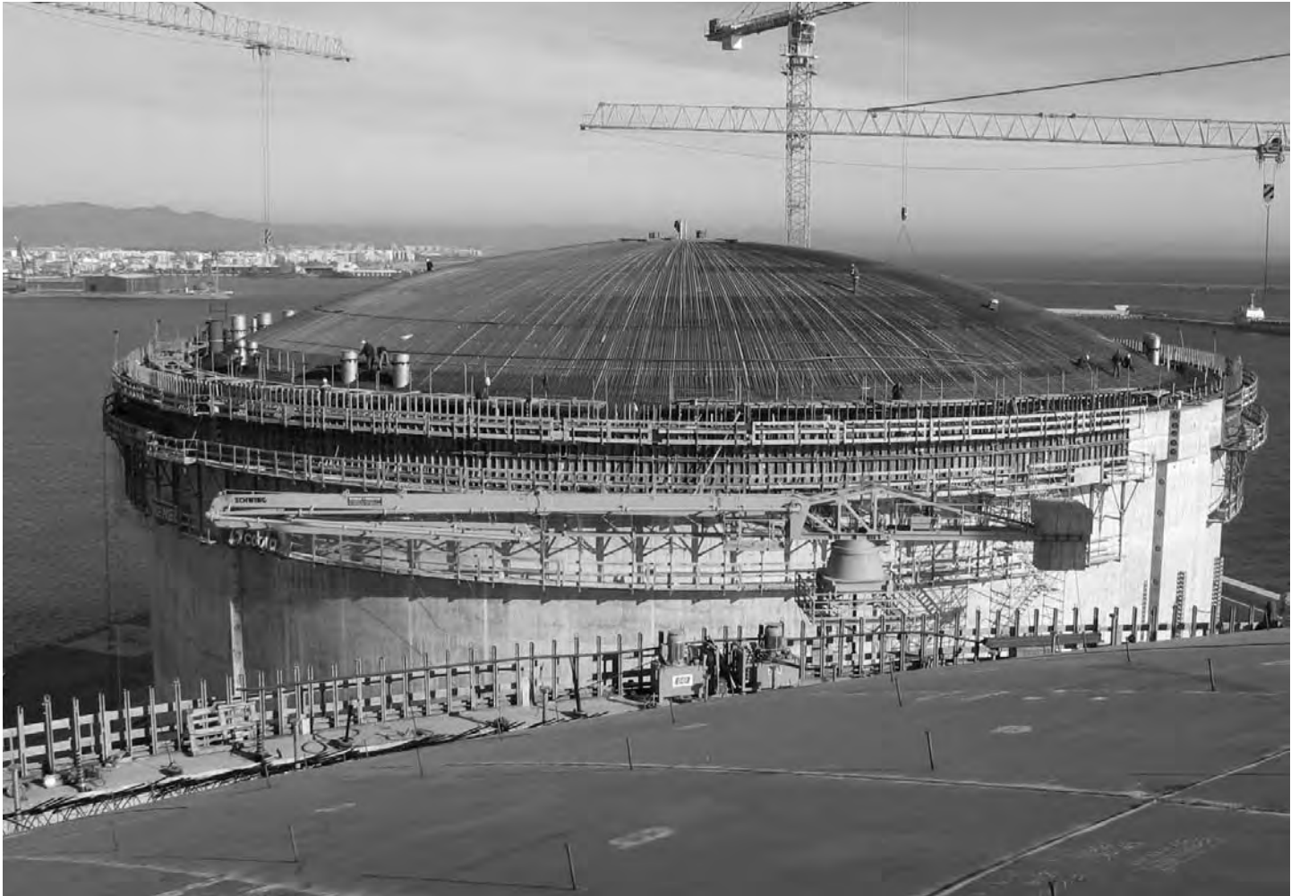
Fig. 7. Tanques criogénicos en Sagunto (Valencia)/ Cryogenic tanks in Sagunto (Valencia).
