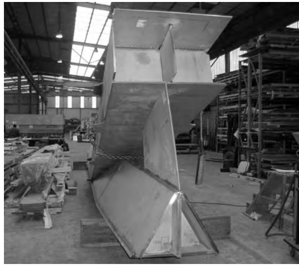
Fig. 7. Vistas del arco y viga longitudinal durante su construcción en taller/ Views of the arch and longitudinal beam during workshop construction.
