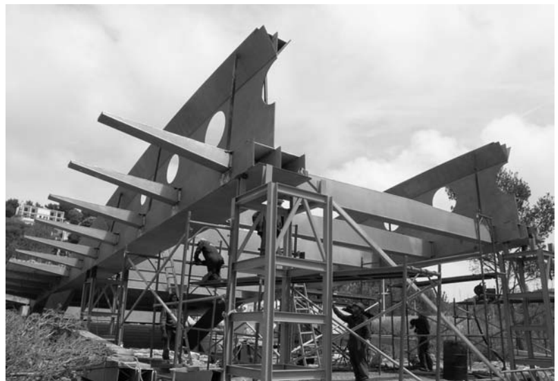
Fig. 15. Montaje de la estructura por tramos/ Assembly of the structure in sections.
