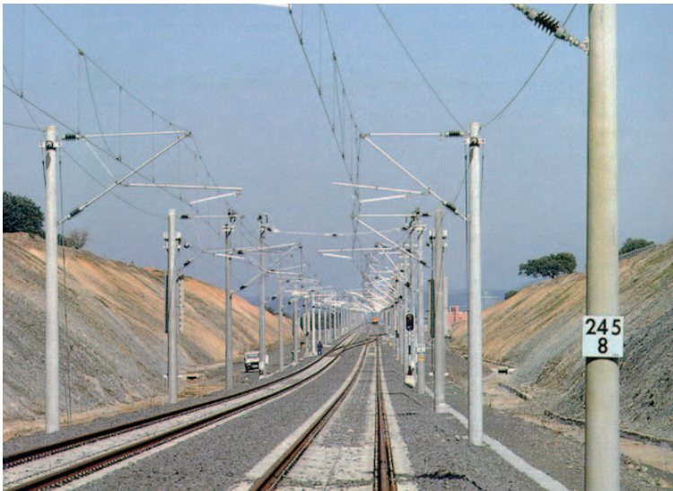
Fig. 6. Electrificación y material de las líneas de Alta Velocidad. Fuente: Ministerio de Fomento/ Electrification and equipment for High-Speed lines . Source: Ministry of Development.
