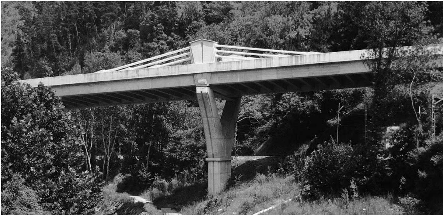
Fig. 4. Aspecto del conjunto formado por una de las pilas y el pretensado extradosado que atraviesa el pylon, de escasa altura.
