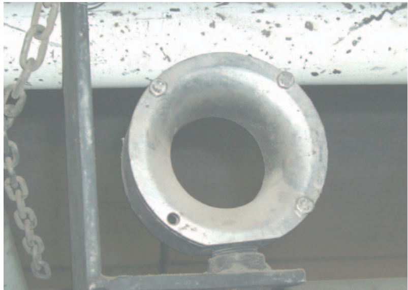
Fig. 10. Detalle de un difusor de aire comprimido para la remoción del aire en zonas de calma dentro del escudo/Close up of a compressed air diffuser for air conditioning in trapped areas within the shield.
