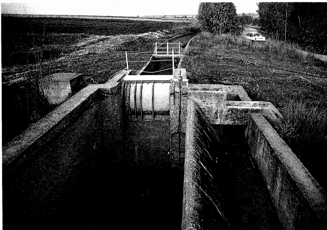
Figura 2. Batería de módulos para distintos caudales en una derivación del Canal de Orellana.
