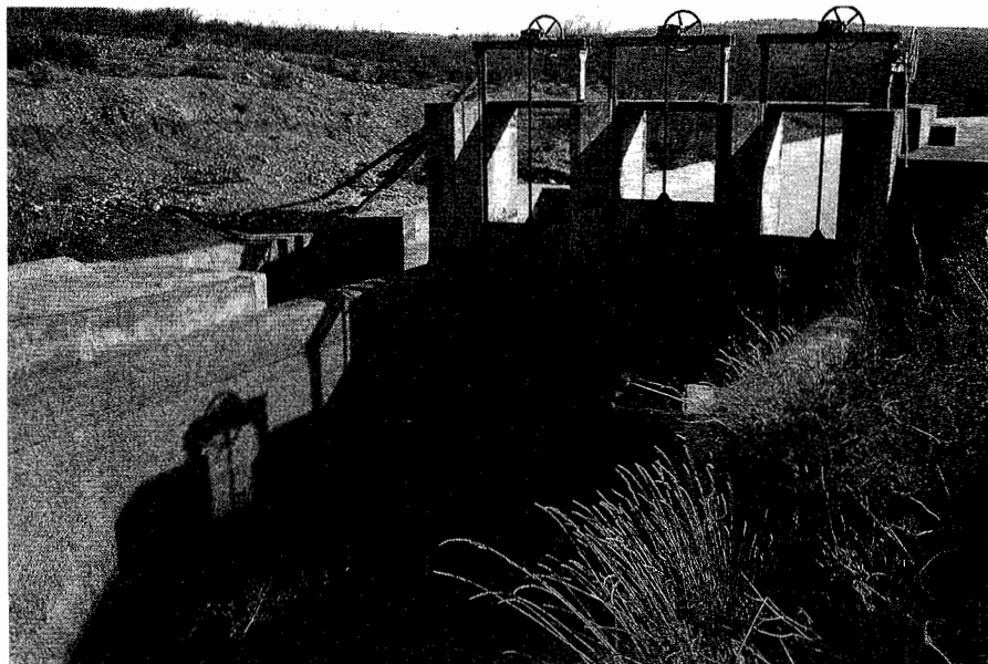
Figura 7. Compuertas tipo «by-pass». A la izquierda está el vertedero del «by-pass» y a la derecha el del aliviadero (Alagón).
