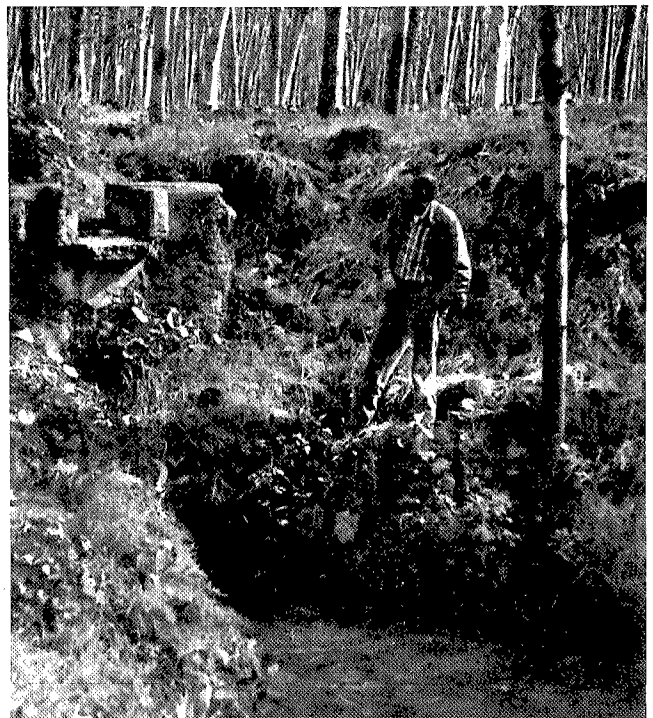
FOTO 5.—Boca de salida del sifón de Jotayar. Las dimensiones en cuanto a sección (1 × 1 varas cuadradas coinciden con las dadas en los escritos de don Agustín, es posible que sea la única obra hidráulica proyectada por Betancourt funcionando en la actualidad.
