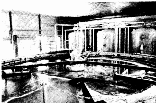
Estación depuradora de Briancos, tanque de flotación de 12,0 m. de diámetro.
