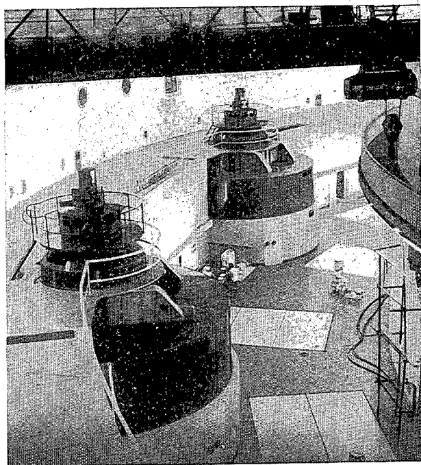
Fig. 9. — Vista parcial de la central hidroeléctrica terminada.
