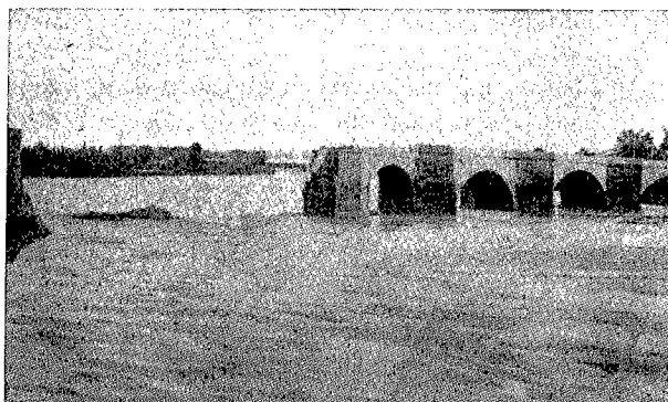
Puente derruido después de la inundación de 1907.
