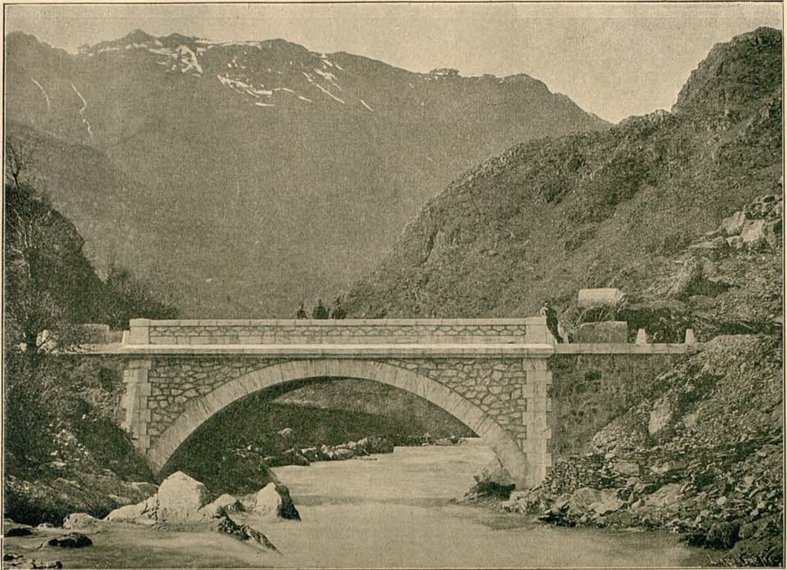
PUENTE SOBRE EL RÍO GARONA.—CARRETERA DE BALAGUER Á LA FRONTERA FRANCESA (LÉRIDA).—SECCIÓN DE VIELLA Á PUENTE DE REY (VALLE DE ARÁN)
