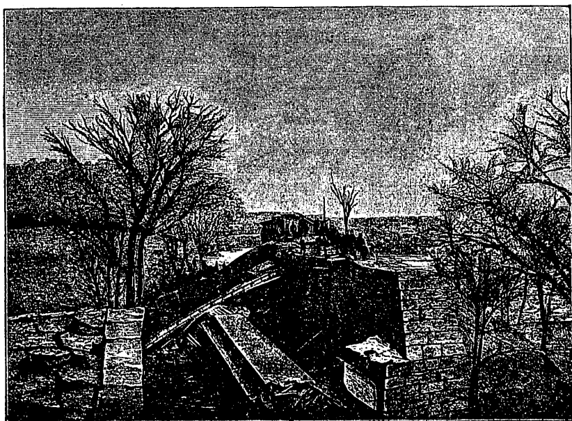
Fig. 8.*—Caída del puente de Bussey, ferrocarril de Boston and Providence (14 Marzo de 1887).
